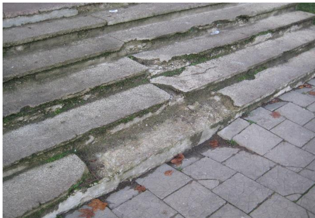
2 pav. Įėjimo laiptų pakopų būklės fragmentas.
