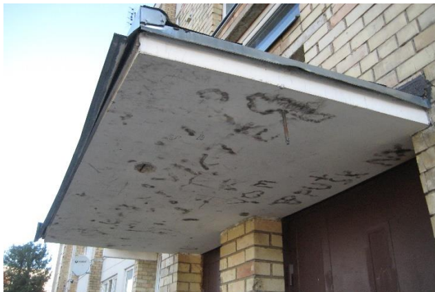
1 pav. Įėjimo stoginių būklės fragmentas.
